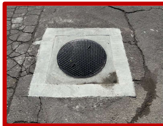
マンホール②(修理済)
